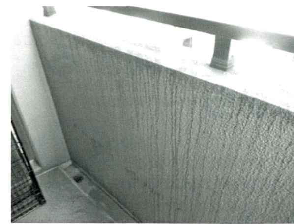
写真4 手摺壁に生じた雨垂れによる汚れ
