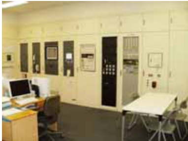
防災センター（1階）
